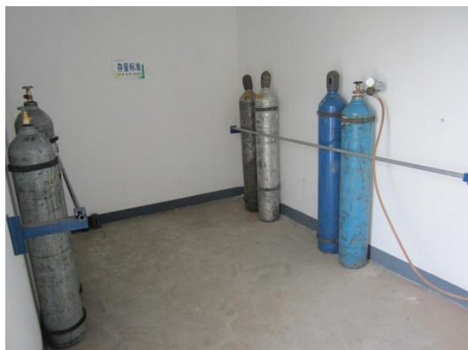
氧气、二氧化碳、氩气堆放区
