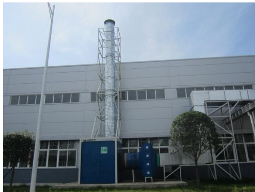
15m 高废气排气筒
