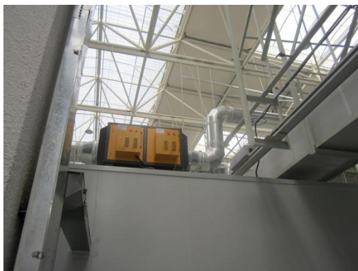
厂房内部废气净化装置及输气管道
