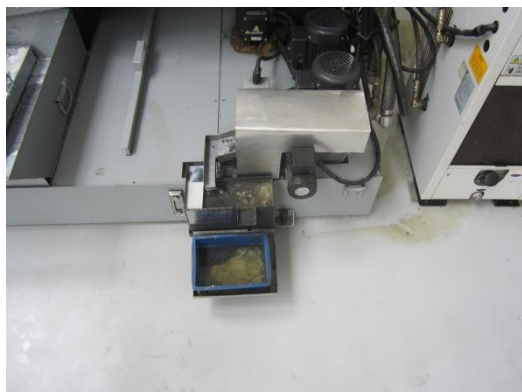
废乳化液及收集装置
