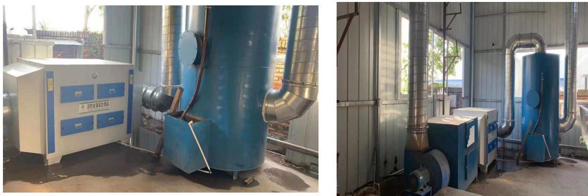
图 3-1 厂区废气处理设施
