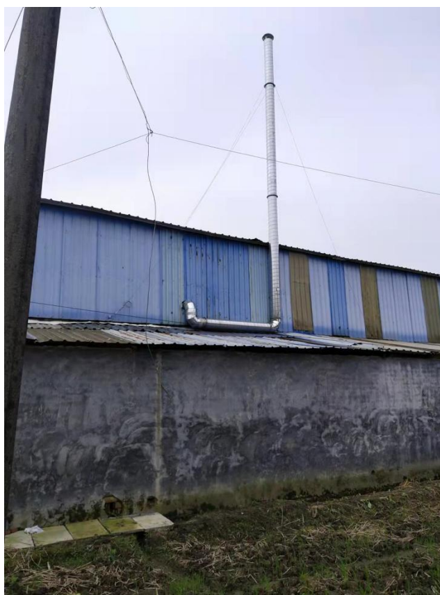
15m 高排气筒
