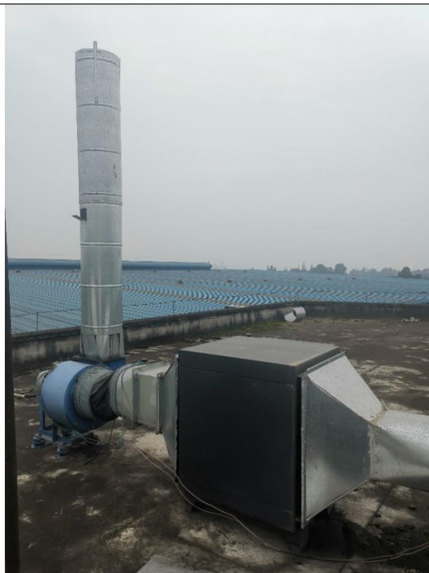
食堂油烟净化器及油烟排气筒 (FQ2)
